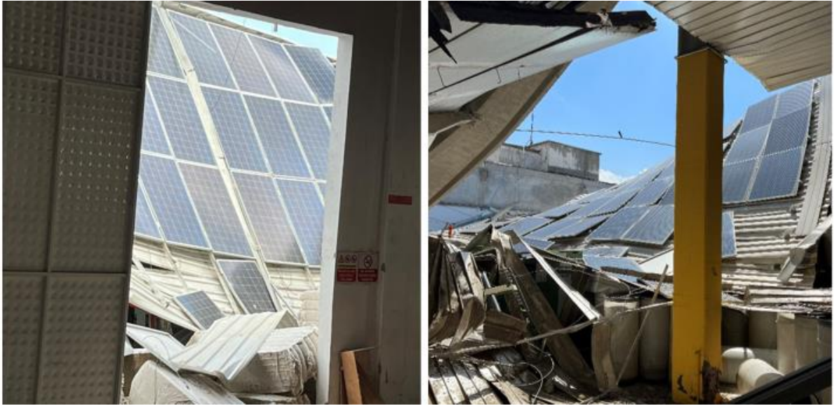
Şekil 6. Çatılarında güneş paneli bulunan iki farklı prefabrik betonarme yapıda deprem nedeniyle yaşanan ağır hasar örneği
