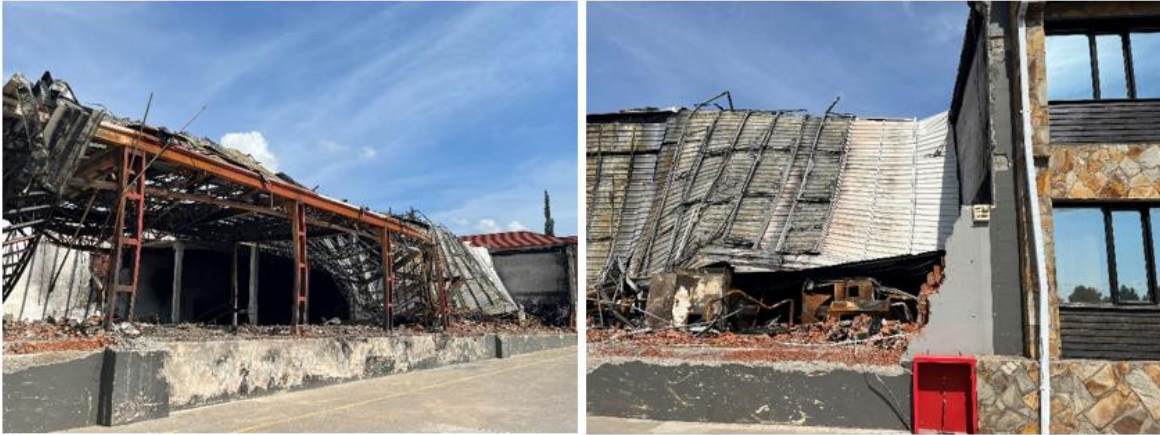
Şekil 7. Deprem sonrası çıkan bir yangında büyük bir hasar yaşanan endüstriyel tesis binası
