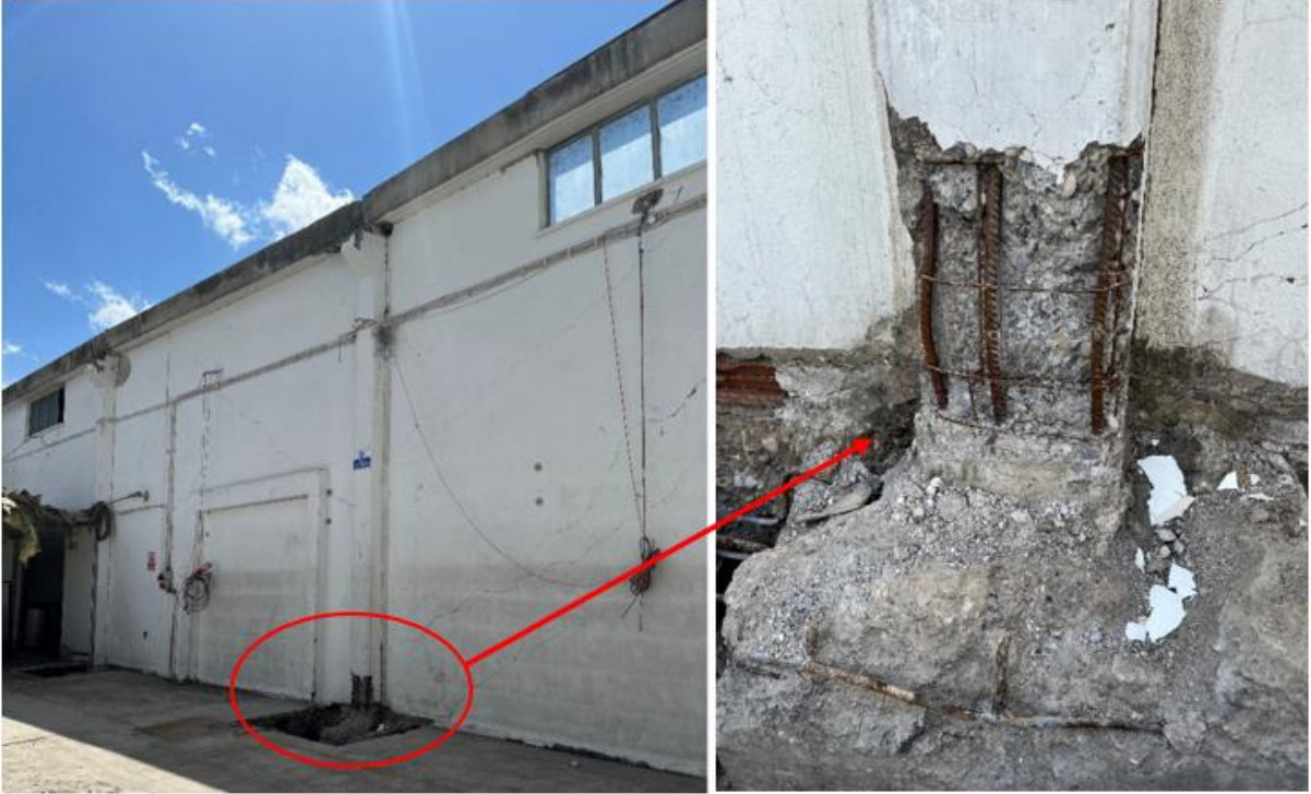
Şekil 2. Etriye cinsi ve sıklığı uygun olmayan prefabrik betonarme kolonda (35 x 35 cm'lik kesite sahip) yaşanan şekil değişikliği (boyuna donatıların akması) örneği
